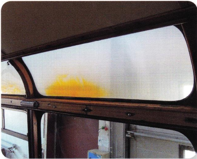
Mattet takbueglass skal skiftes ut.
